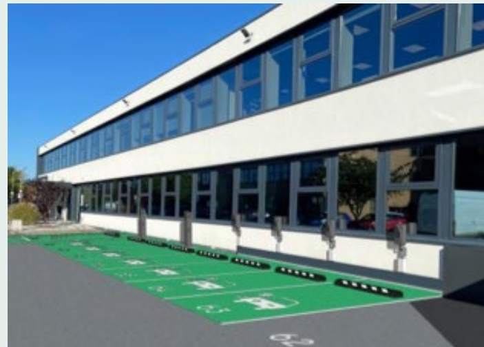
8x22kW Etrél EV sockets
